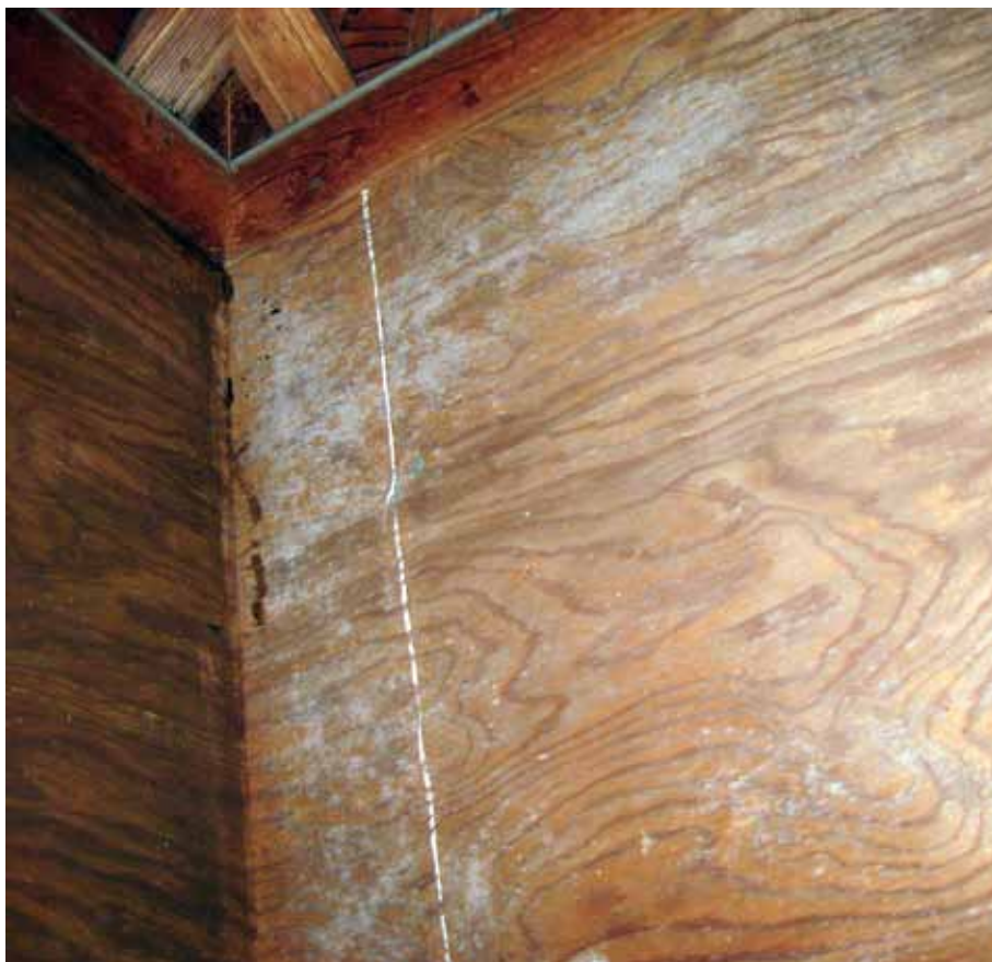
Fig. 3 - Aspecto de duas pranchas da sanca com orifícios de saída de xilófagos e fungos.
